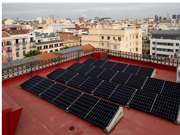
Ejemplo de instalación en vivienda unifamiliar y comunidad.
