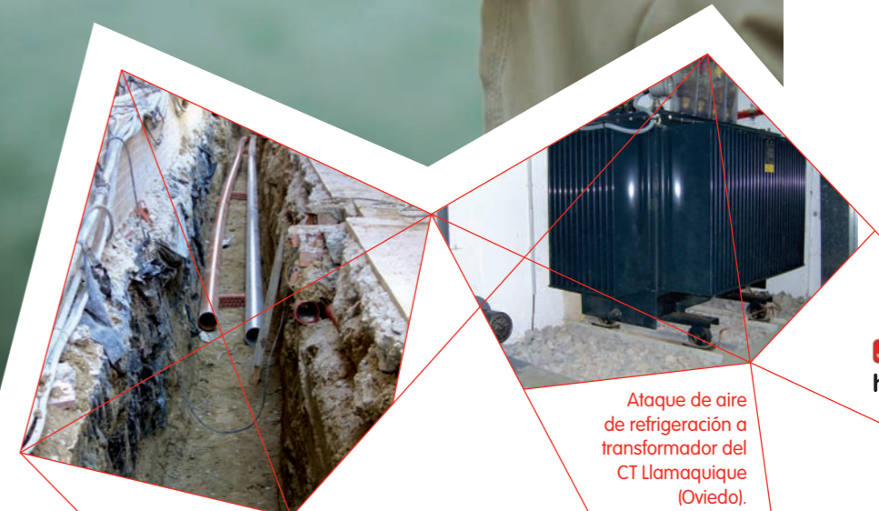
Tubos enterrados para ventilación al CT Ronda 3 (Pinto-Madrid).
