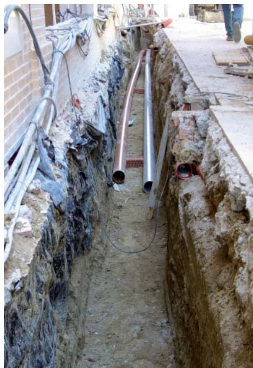
Tubos enterrados para ventilación al CT a 3 (Pinto-Madrid)
